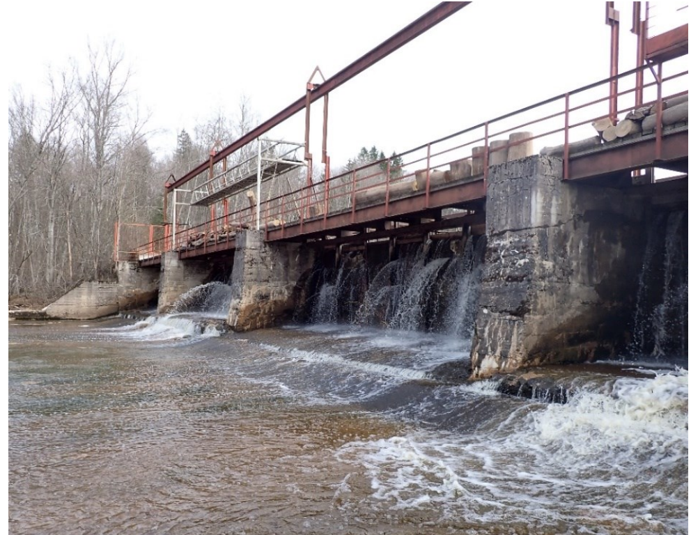
Vecogres HPP on Ogre river
